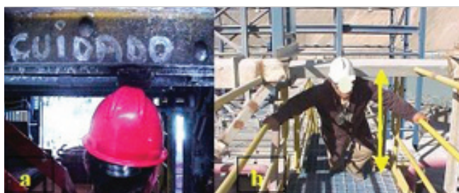
Figura 1: Imágenes de problemas estructurales
