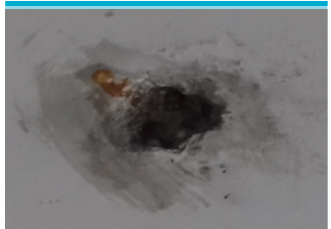
Figura 4: Um vazamento do teto a reparar.
