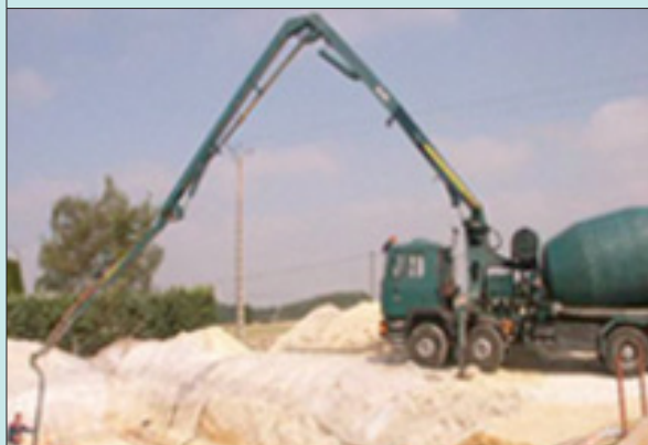
Foto 2: Bomba misturadora avariada cujo operador manipula a mangueira
