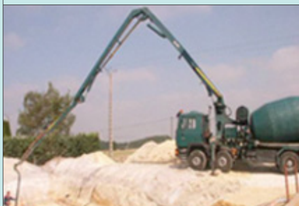
Foto 2: Bomba misturadora avariada cujo operador manipula a mangueira
